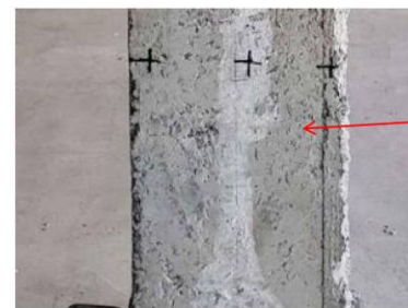
4F:柱(補修前)
