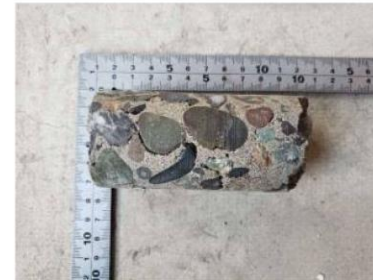
4F:柱(補修前)
