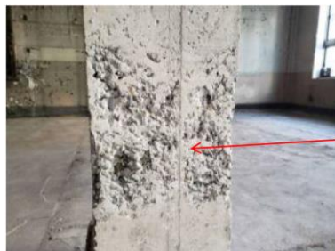
3F:柱(補修前)
