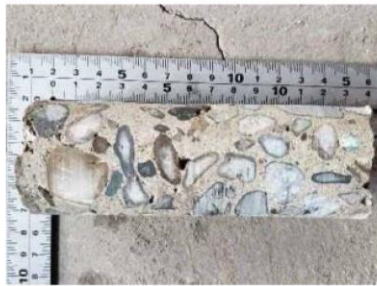
3F:柱(補修前)
