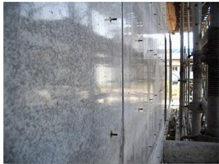
▲ コンクリートが固まり型板を外したところ、美しいコンクリート面が現れる
